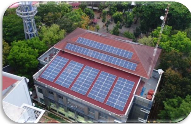
Solar Panel (Gd. UPT TIK)
